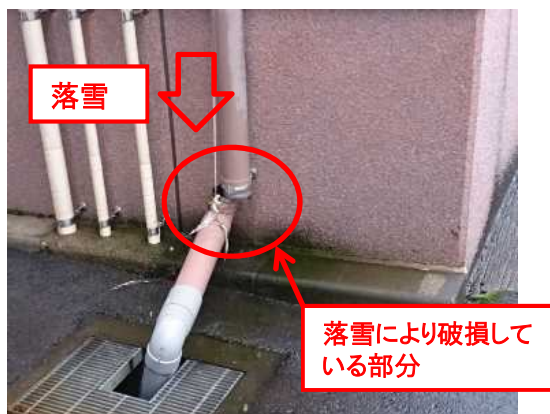
写真2 雨水用ドレン配管が破損
