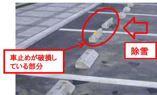
写真3 車止めが破損
