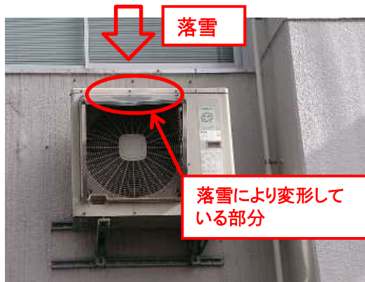
写真1 室外機用フードが変形
